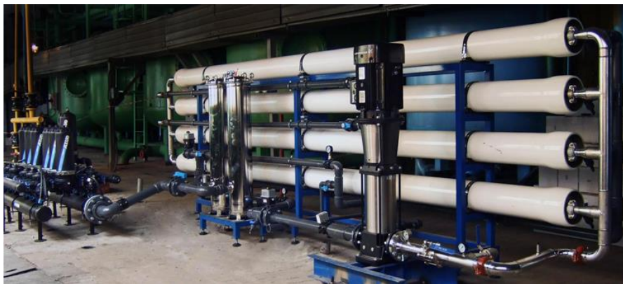
Рисунок 2. Установка нанофильтрации для очистки речной воды на «Полоцкой ТЭЦ»
